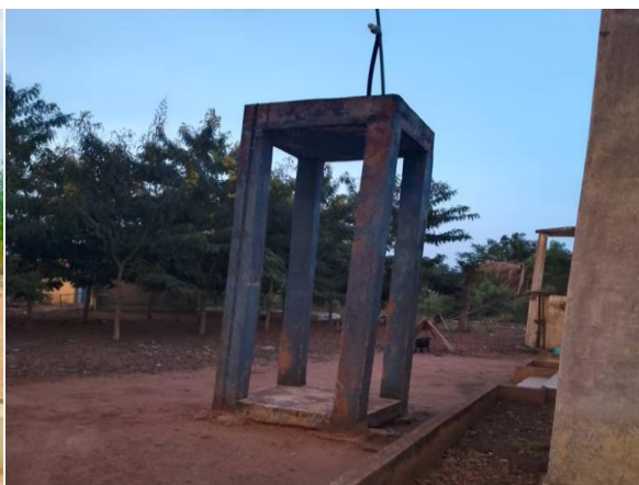
Photo 16. Système de stockage d'eau défectueux du CMS. Prise de vue : Consultant, 2025
