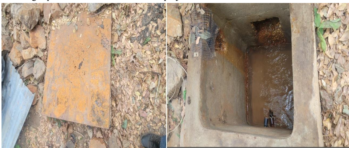
Première source de captage située sur le flanc de la montagne (point d'émergence d'eau)
