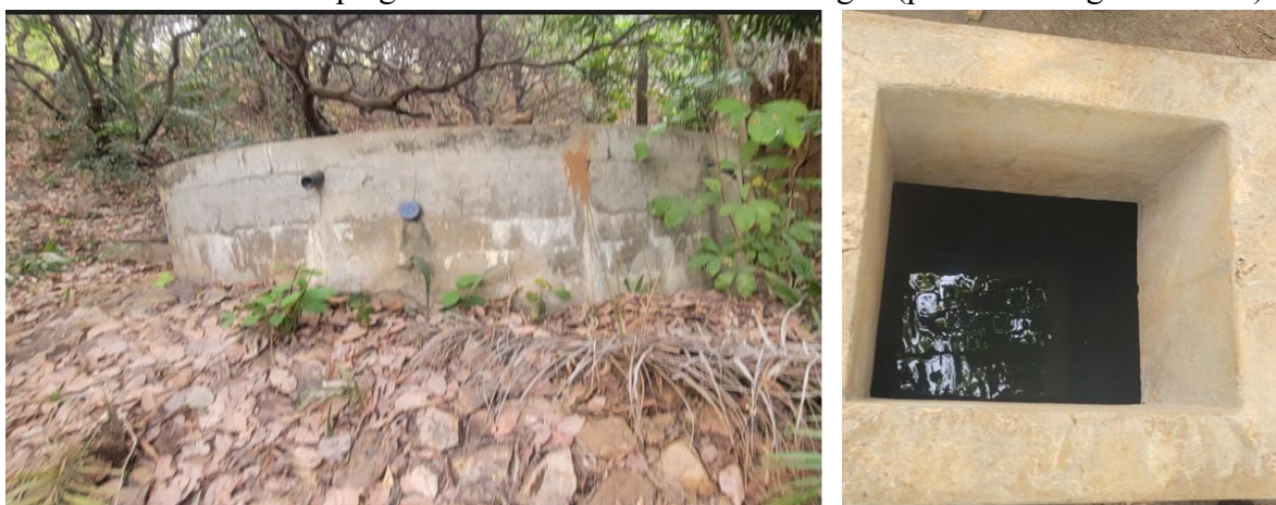
Le reservoir au sol de la première source de captage
