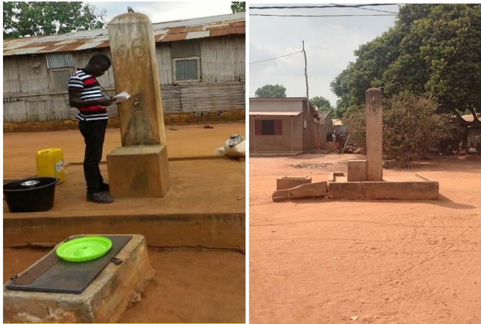
Planche 2 : Borne fontaine existante dans la localité de NOÉPÉ 2017 et 2025(Prise de vue,Consultant, 2025)
