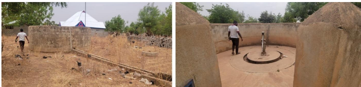
Photo 7 : PMH en panne et non fonctionnelle dans la localité. Prise de vue : Consultant, 2025.
