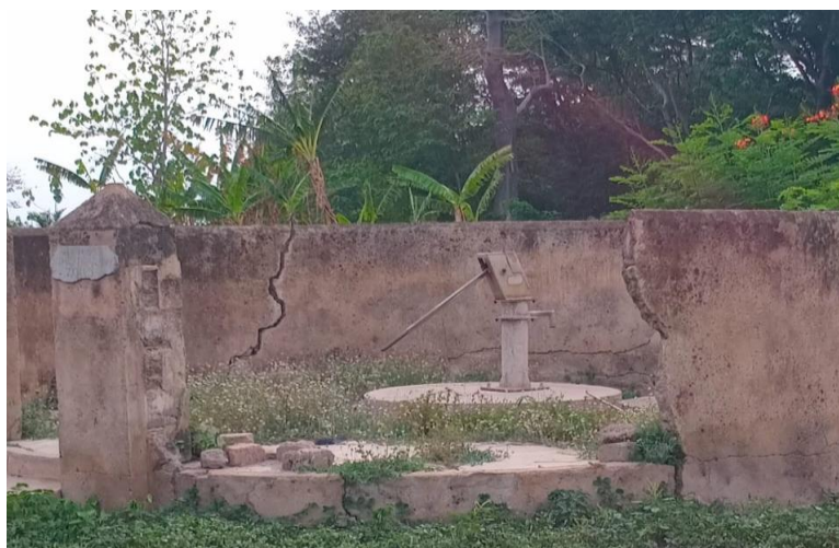
Photo 6: Forage abandonnée à cause de l'eau potassée (Prise de vue, Consultant, mars 2025)
