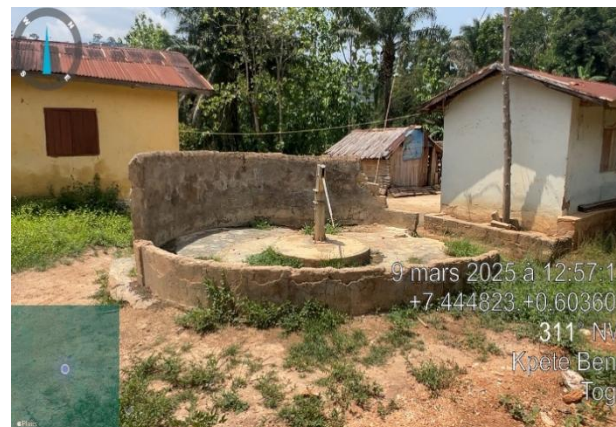
Photo 16 : Aperçu d'une ancienne pompe à motricité humaine à Kpete Bena
