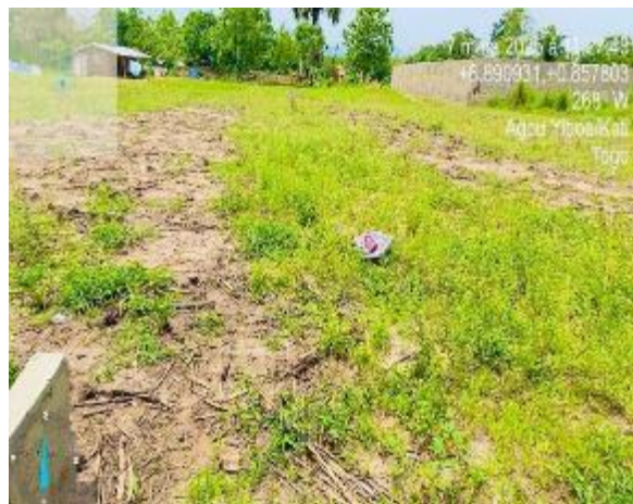
Photo 10: Vue d'ensemble d'un passage de la conduite de distribution de l'eau à Kati Prise de vue : Consultant, Mars 2025
