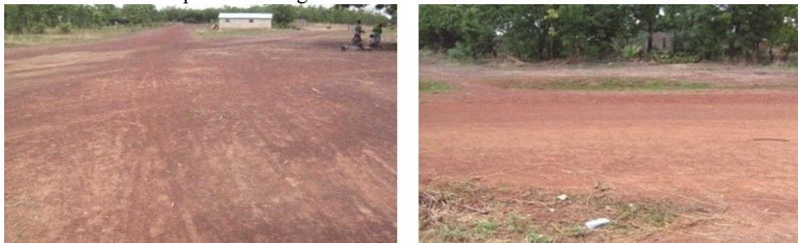
Photo 3 : Emprise réservée au transit des canalisations d'eau Prise de vue : Consultant, Février 2025.
