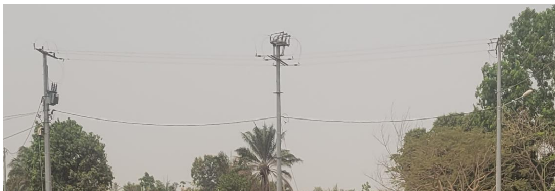
Photo 5: Les files électriques dans les localités du projet
