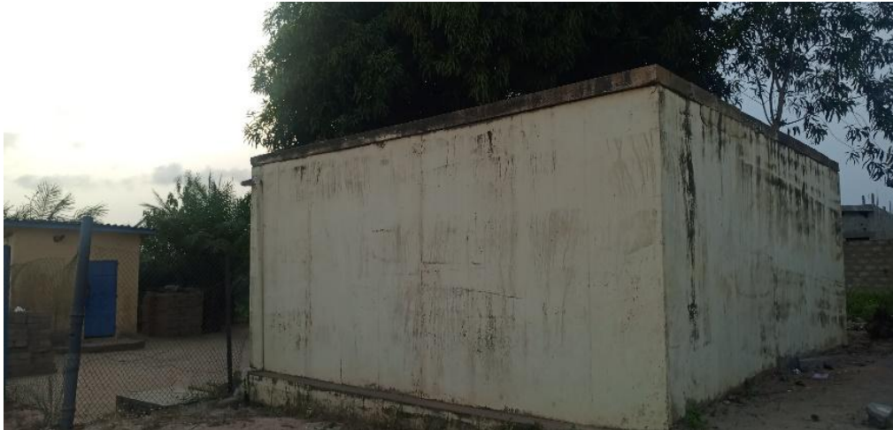
Photo 3: Tank de stockage existant et ralié au château existant (Prise de vue Consultant, mars 2025)
