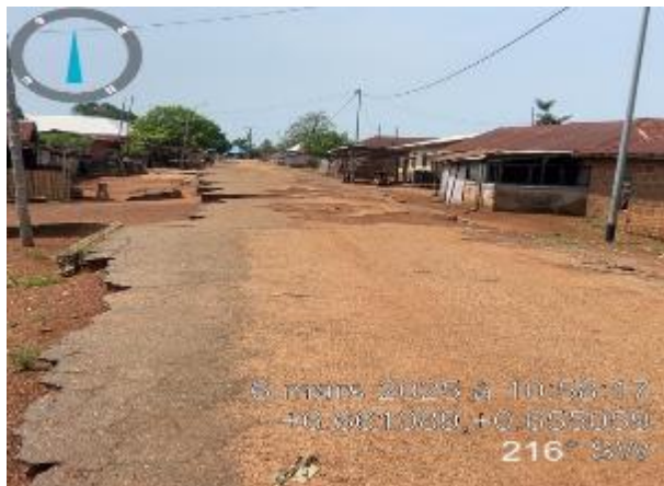
Photo 14: Vue d'ensemble d'un passage de la conduite de distribution de l'eau à Agotime Nyitoe
